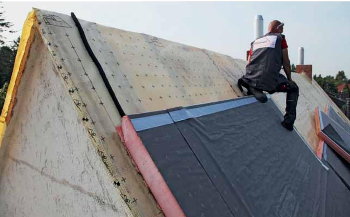
Die Dämmelemente wurden auf der Luftsperrle mit umlaufend angeordnetem Komprimband verlegt und mittels Systemschrauben durch die Konterlatte mit dem Tragwerk fixiert.
