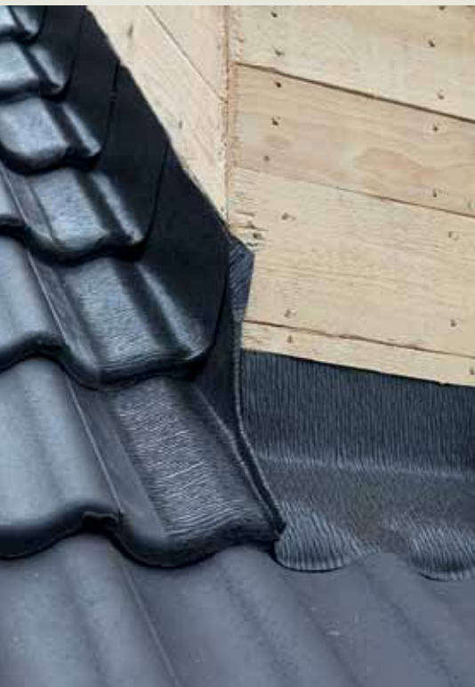
Die Gaubenanschlüsse wurden mit einem rollbaren Anschlussband mit Verstärkungsgitter und unterseitiger, vollflächiger Butylbeschichtung in Schichtstücken sowie Stehfalz ausgeführt.
